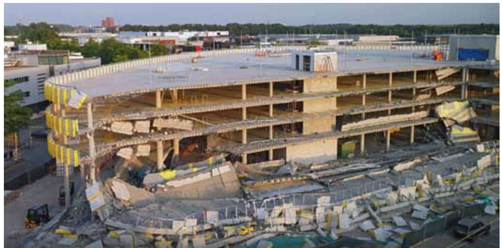
4.2 Ingestorte parkeergarage in Eindhoven (2017) doordat tijdens de bouw de inwendige krachten de materiaalsterkte overschreden.
