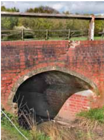
8.1 Scheuren in metselwerk door zettingsverschillen.
