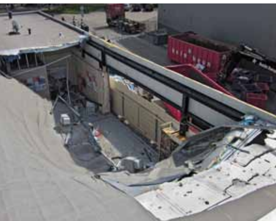
8.2 Plat dak, lokaal bezwaken door regenwateraccumulatie.
